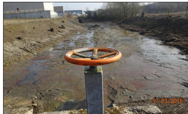
Bassin d'orage opérationnel (10.000 m 3 )
