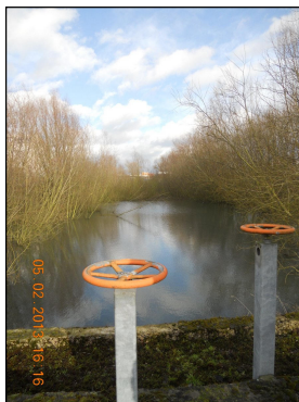
B.O. inopérant avant les travaux
